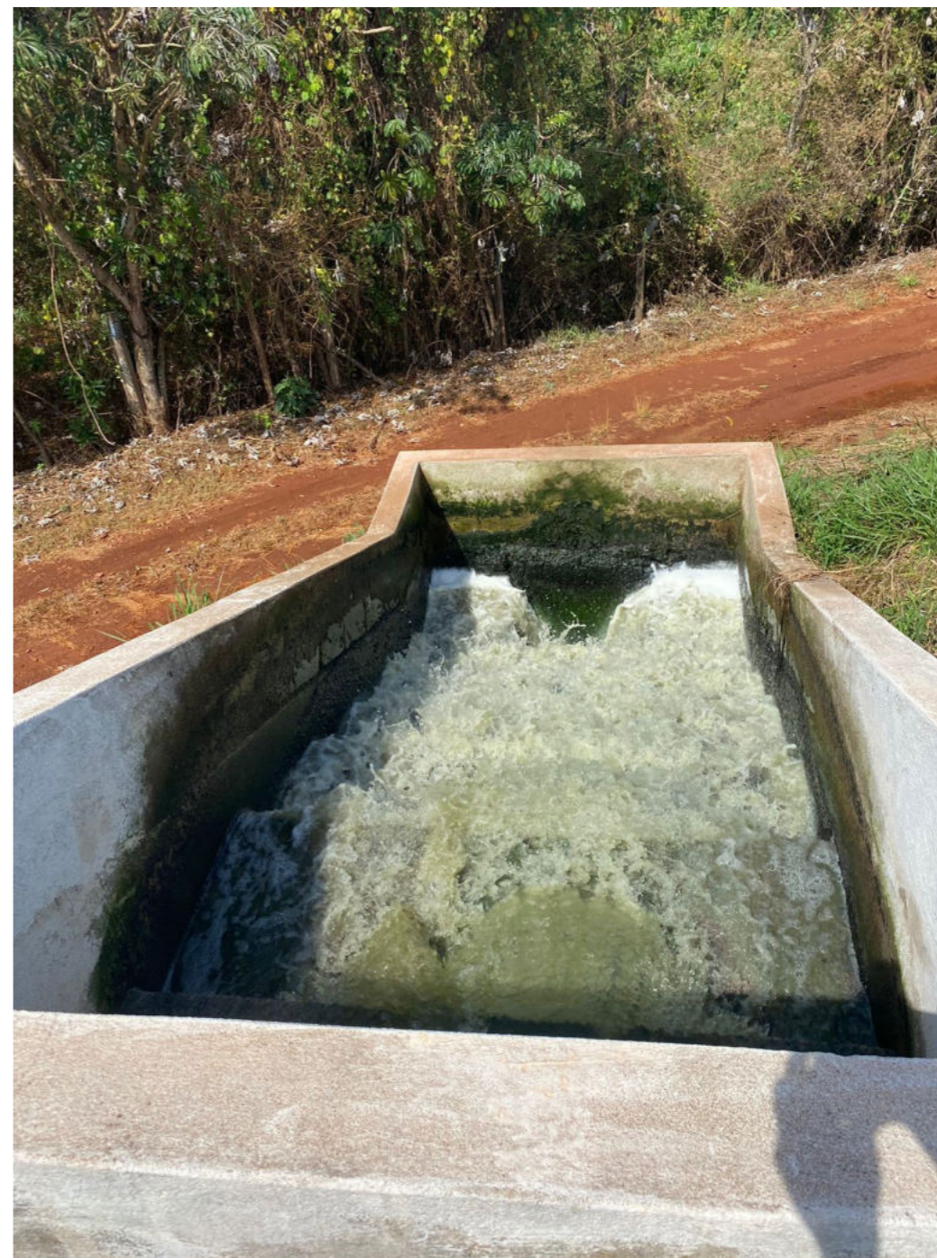
Figura 161 – Escada Aeradora da ETE Guará.
