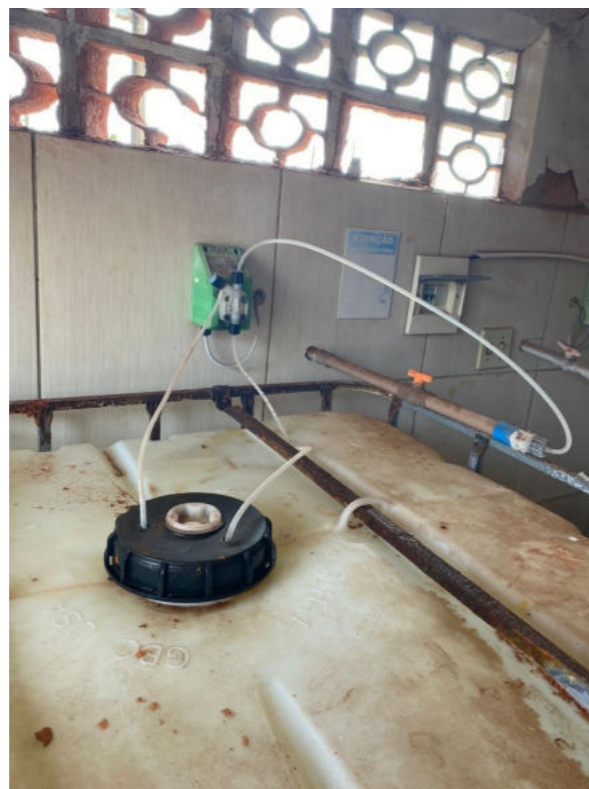
Figura 40 – Bomba dosadora de cloro.
