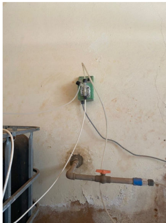
Figura 87 – Bomba dosadora de cloro.
