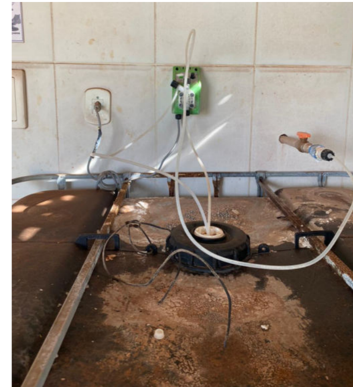
Figura 68 – Bomba dosadora de cloro.
