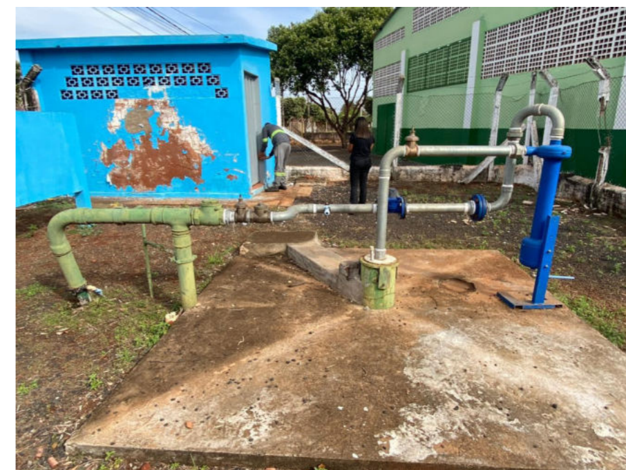
Figura 44 – Poço UP 09 com sistema de filtragem.
