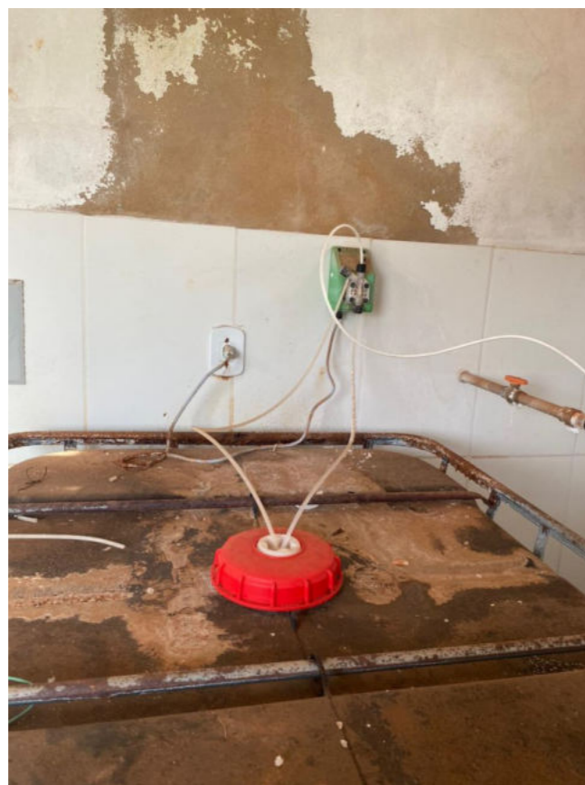
Figura 76 – Bomba dosadora de cloro.
