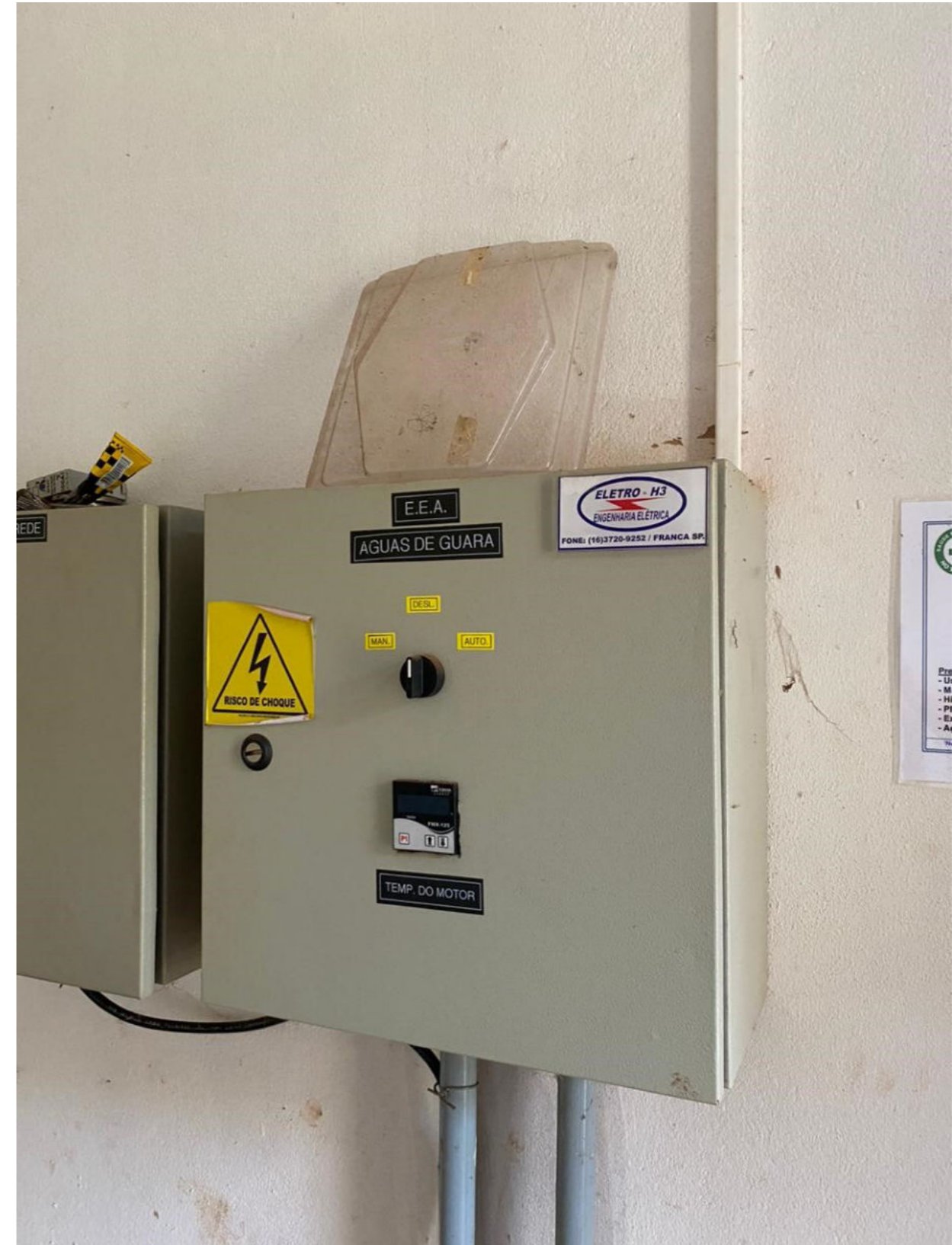
Figura 95 – Painel de comando.
