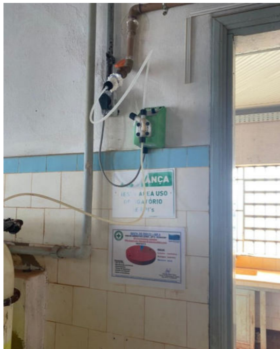
Figura 18 – Bomba dosadora de Cloro.
