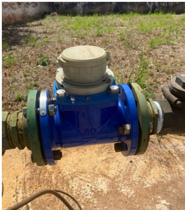
Figura 81 – Macromedidor UP Pioneiros.
