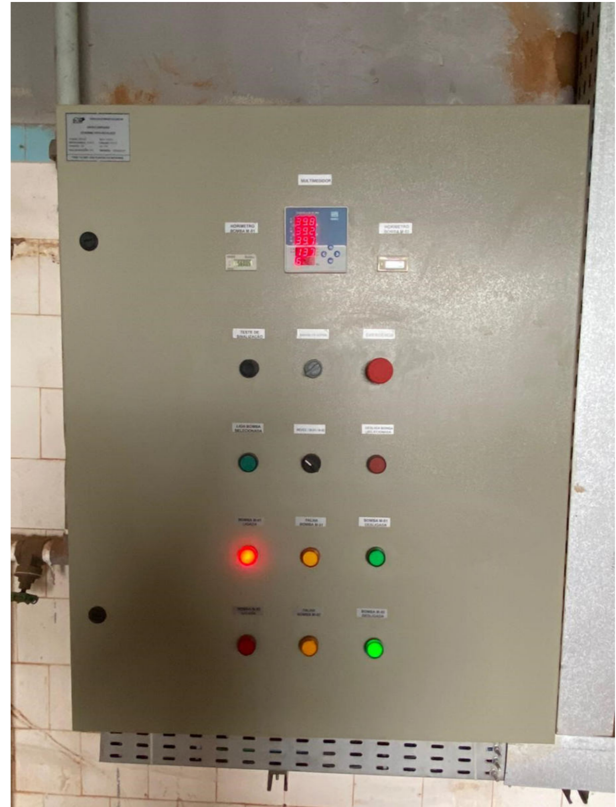
Figura 22 – Painel de comando.
