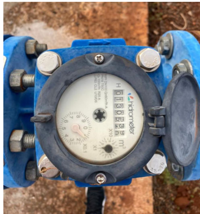
Figura 55 – Medição Macromedidor UP 10.
