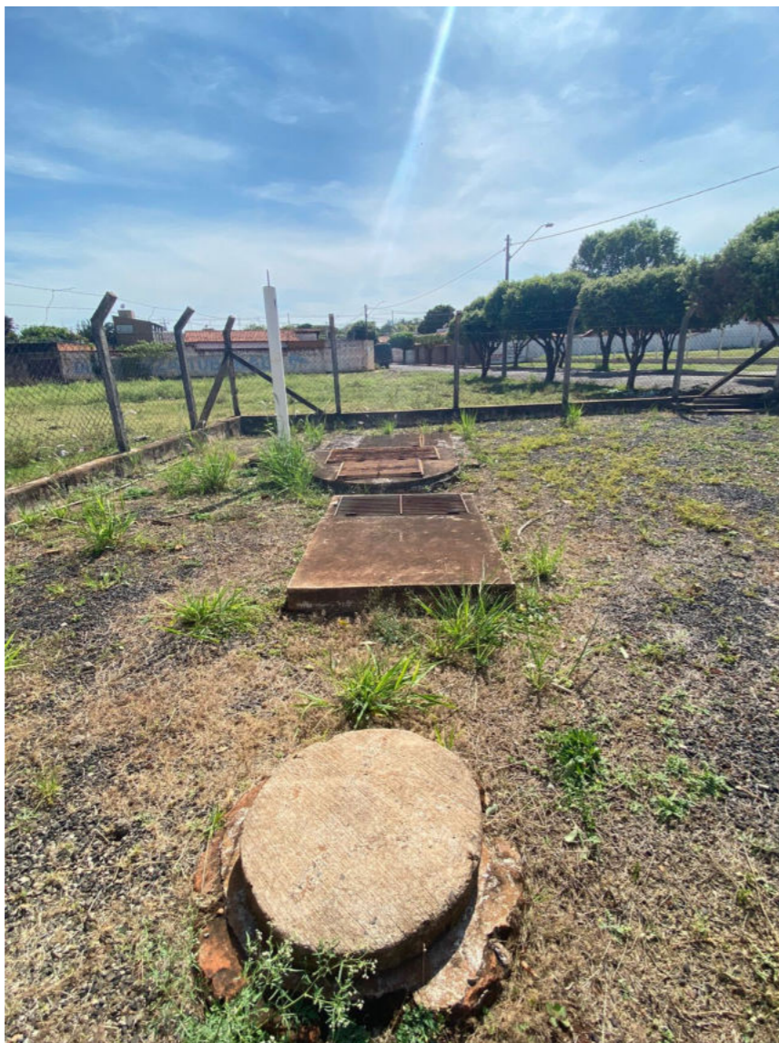
Figura 140 – Estação Elevatória de Esgoto Sete de Setembro.
