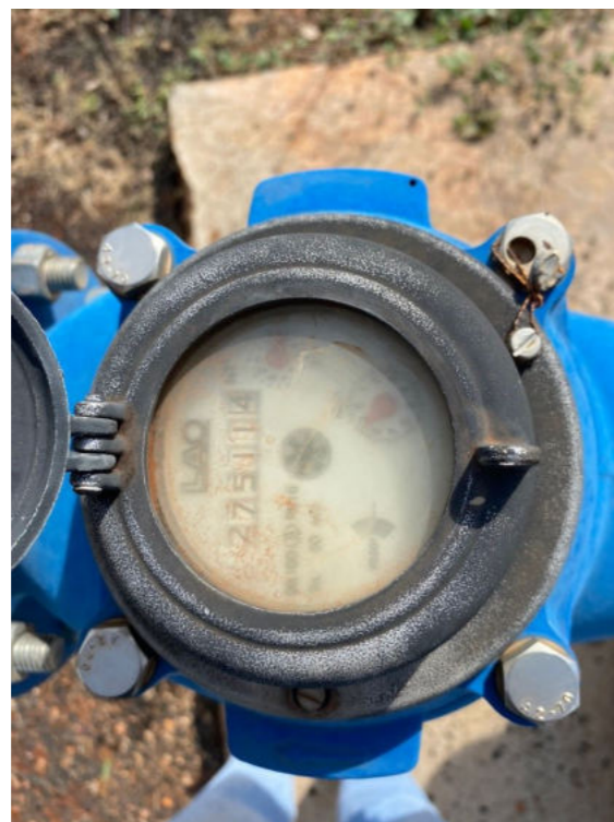
Figura 37 – Medição Macromedidor UP 08.
