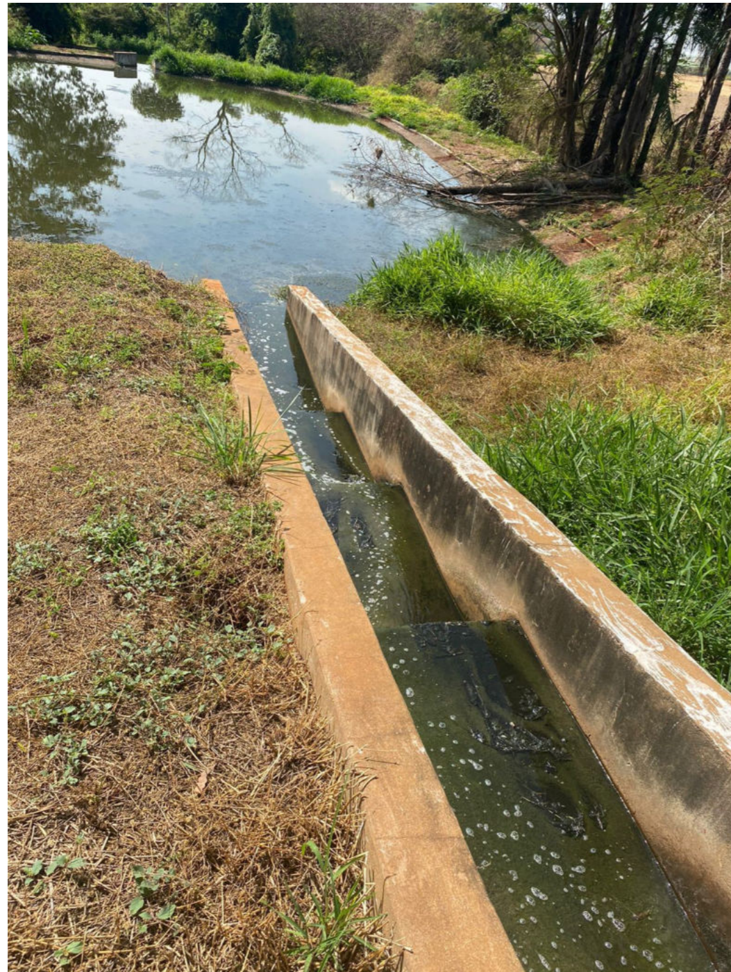
Figura 167 – Entrada do efluente na 2ª Lagoa Facultativa.
