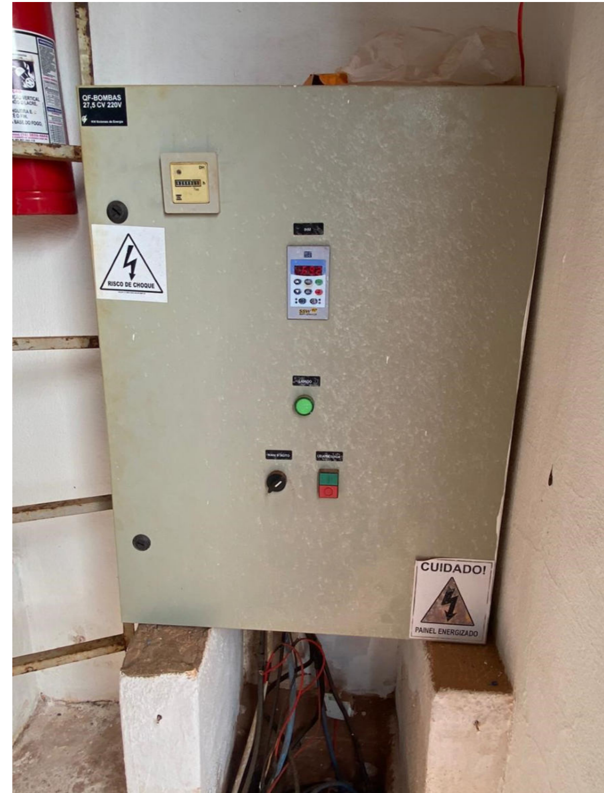
Figura 50 – Painel de comando.
