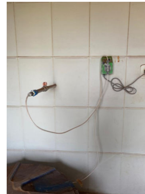
Figura 69 – Bomba dosadora de flúor.
