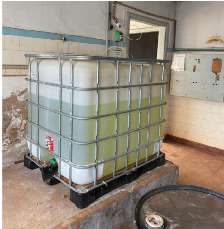
Figura 17 – Caixa de armazenamento de cloro.
