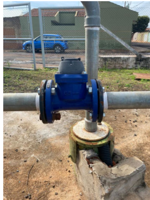
Figura 45 – Macromedidor poço UP 09.
