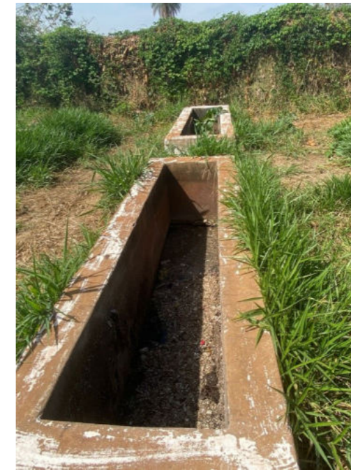
Figura 163 – Chegada do efluente na ETE Pioneiros.
