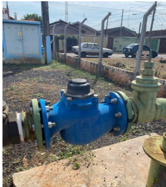
Figura 36 – Macromedidor Poço UP 08.
