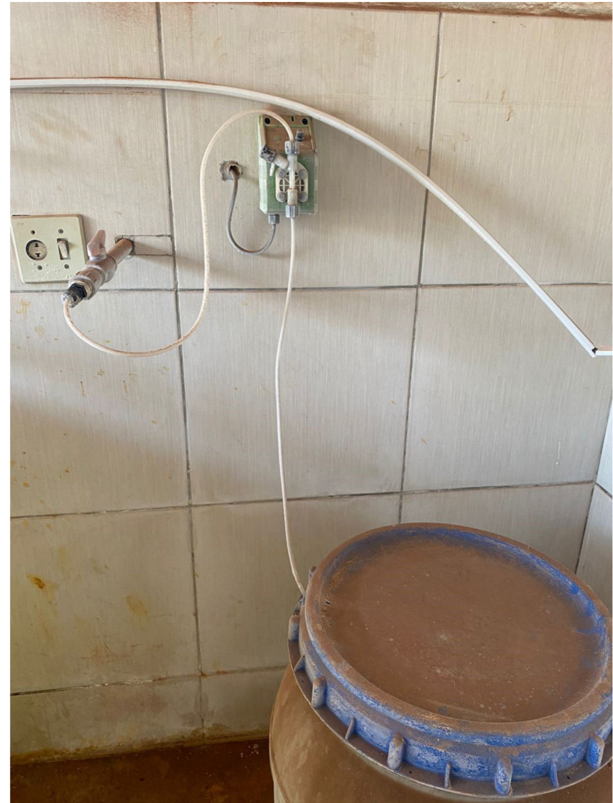
Figura 41 – Bomba dosadora de flúor.
