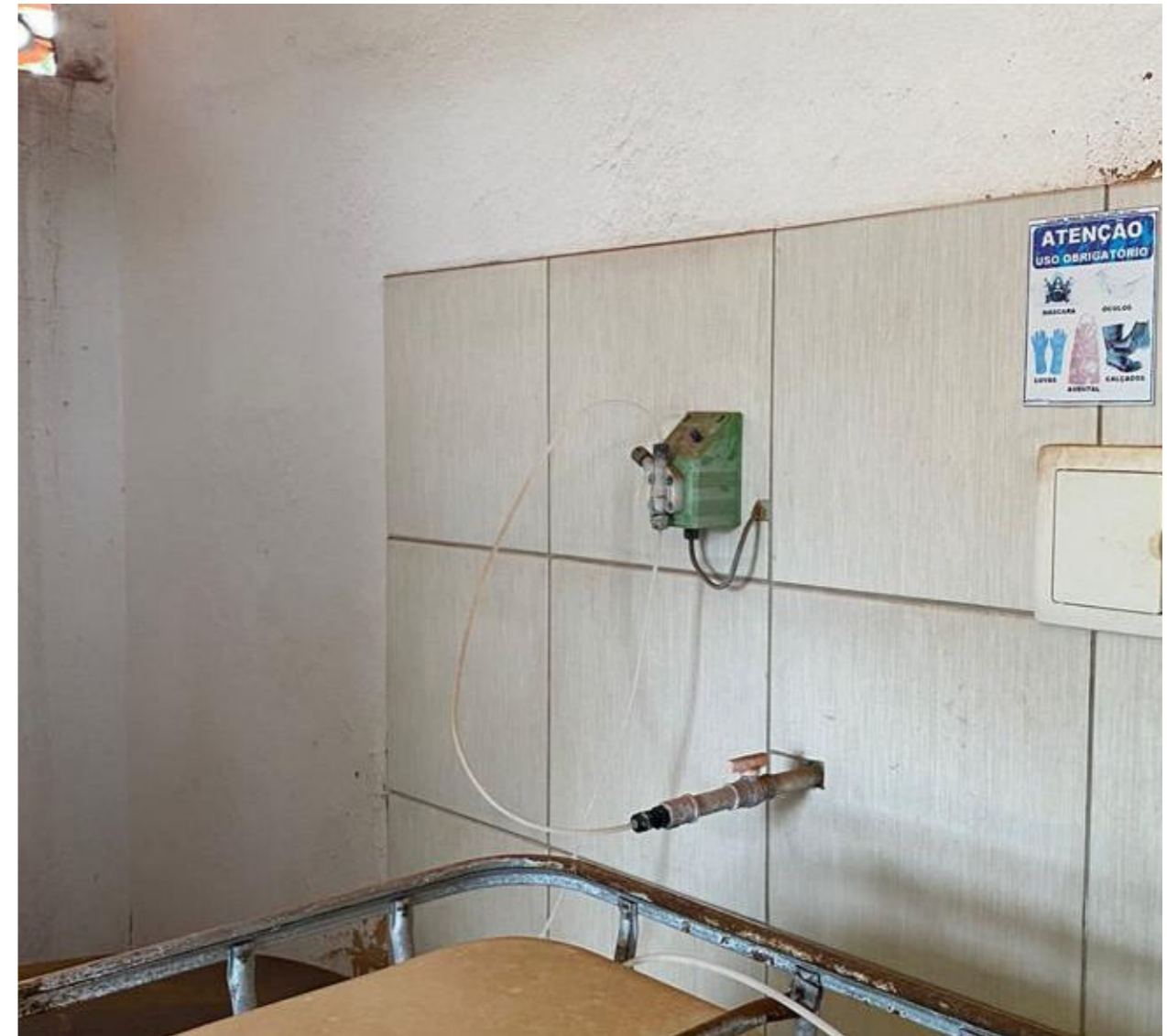
Figura 59 – Bomba dosadora de flúor.
