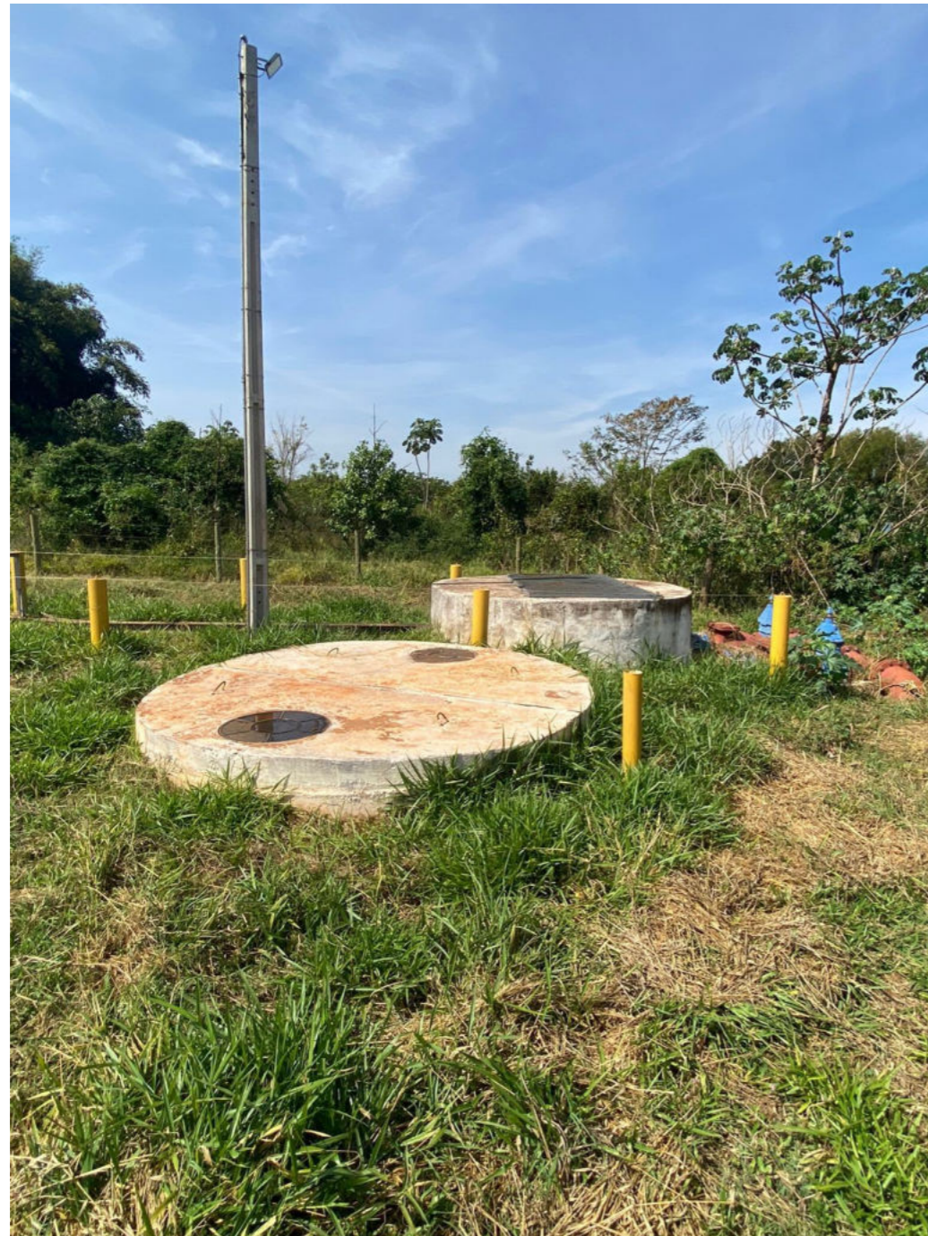
Figura 145 – Estação Elevatória de Esgoto da ETE Guará.
