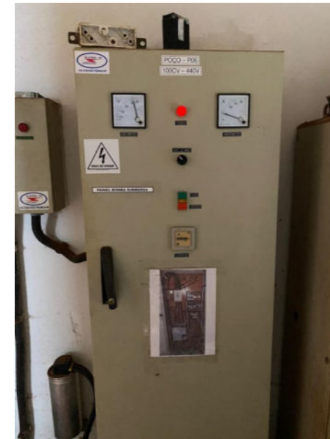
Figura 31 – Painel de comando.
