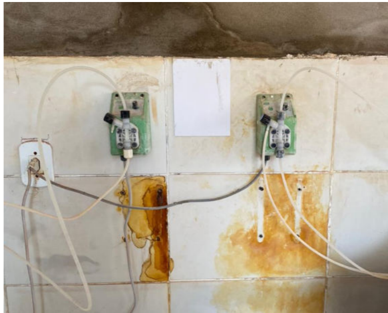
Figura 29 – Bombas dosadoras de cloro e flúor.
