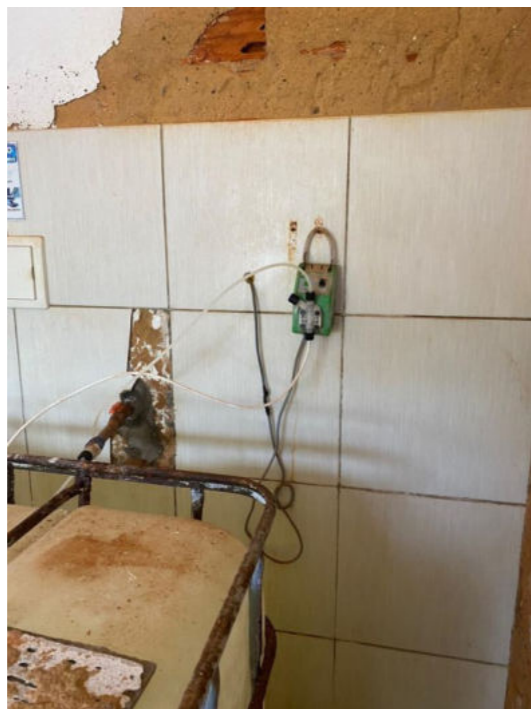
Figura 58 – Bomba dosadora de cloro.
