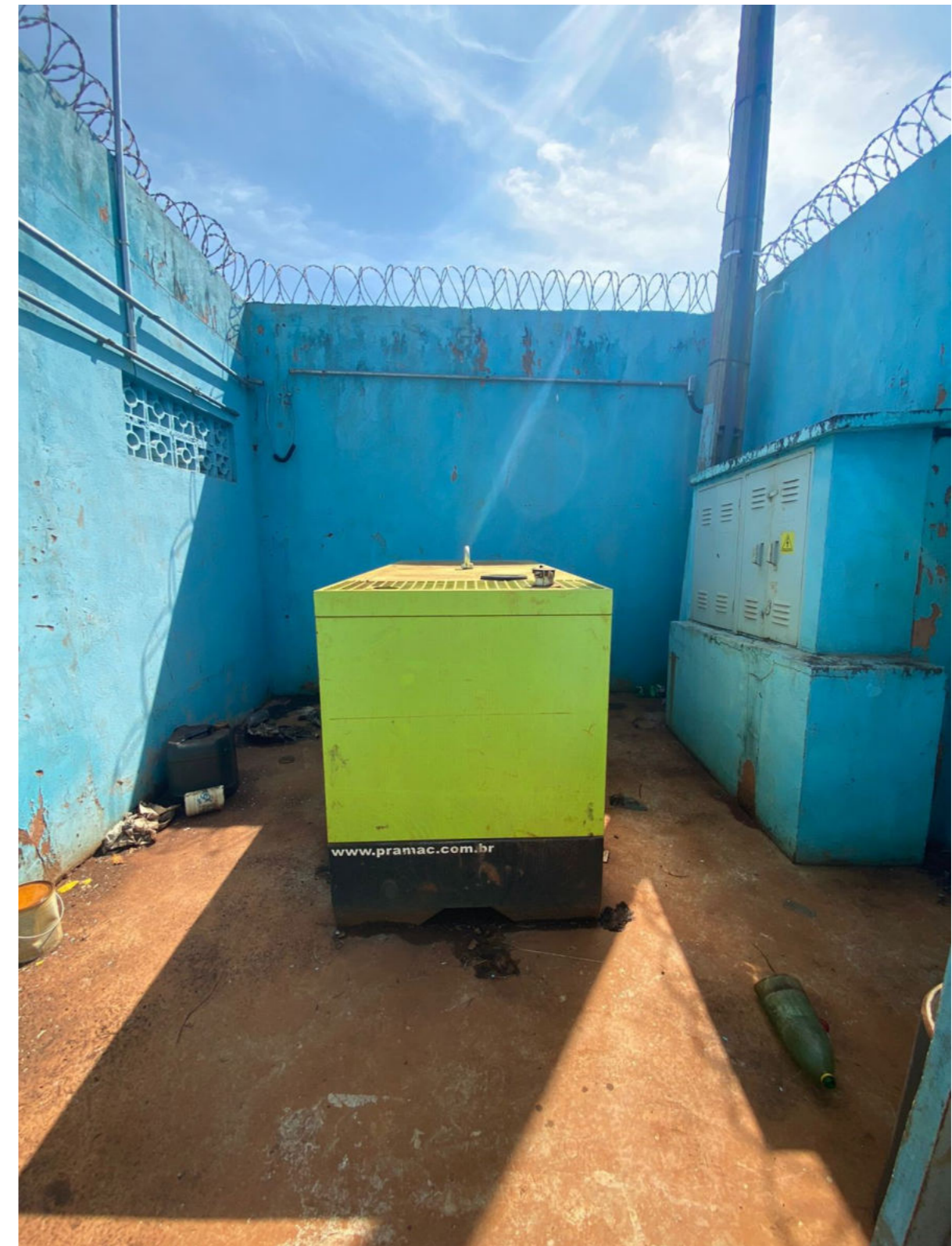
Figura 159 – Gerador de Energia.
