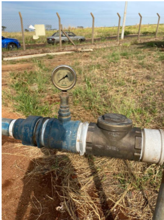
Figura 62 – Medidor de pressão – Poço UP 11.
