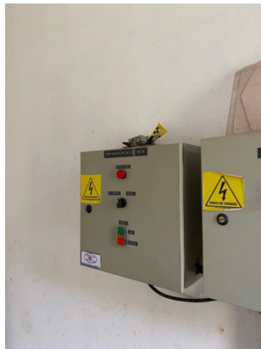
Figura 94 – Painel de comando.
