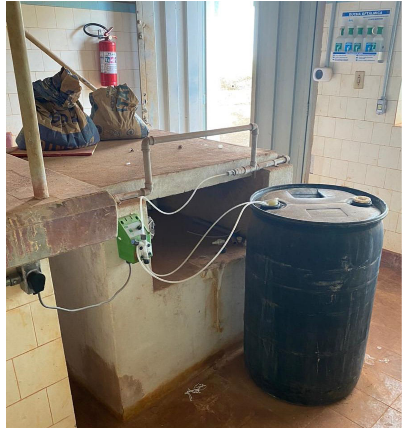
Figura 19 – Bomba dosadora de Flúor.
