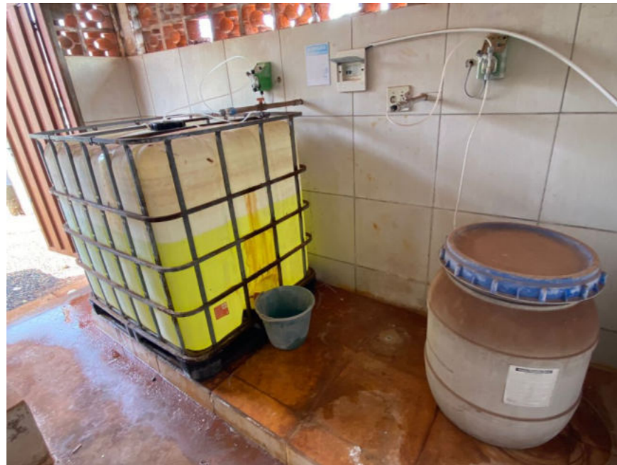
Figura 39 – Dosagem de cloro e flúor.
