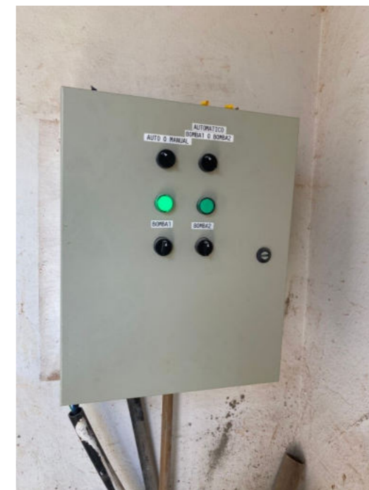
Figura 142 – Painel Elétrico da EEE Sete de Setembro.
