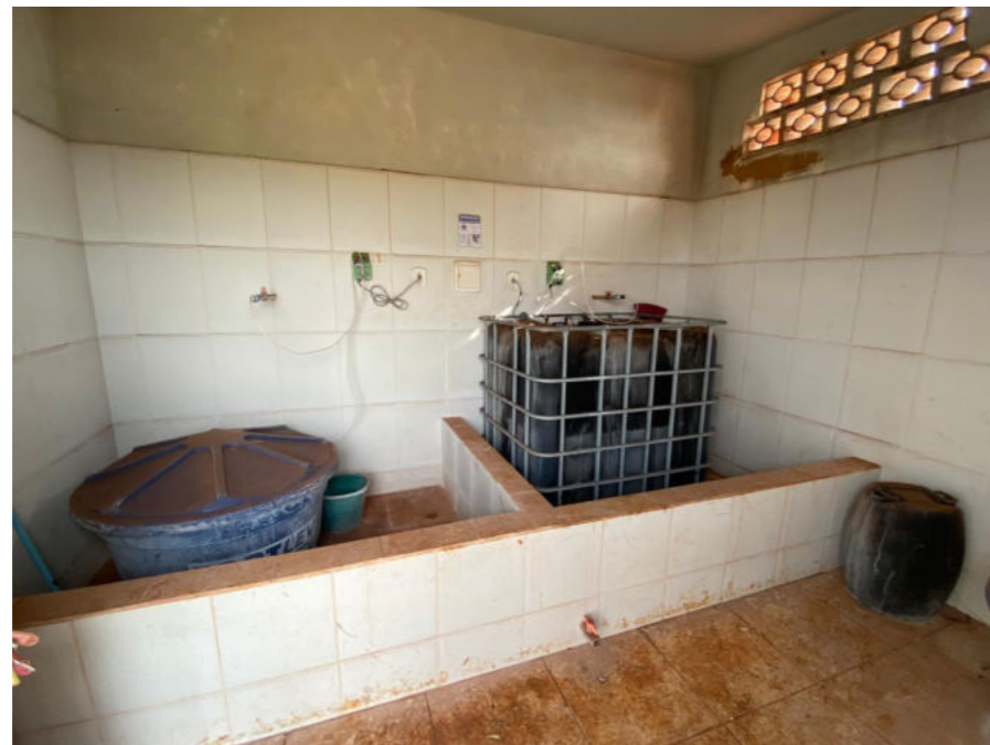
Figura 67 – Dosagem de cloro e flúor.
