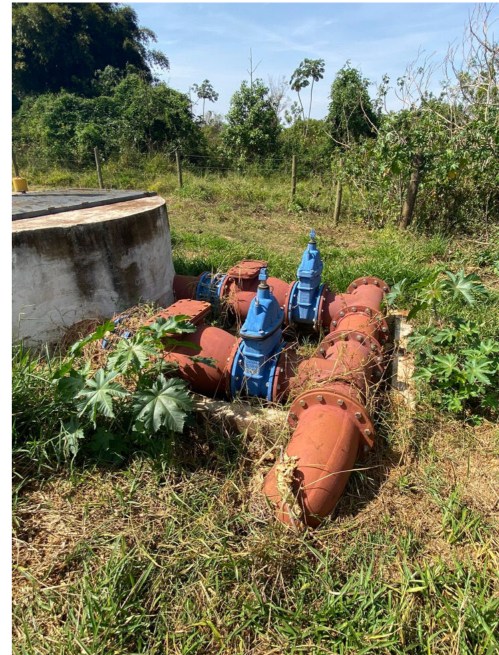
Figura 146 – Bombeamento da EEE da ETE Guará.
