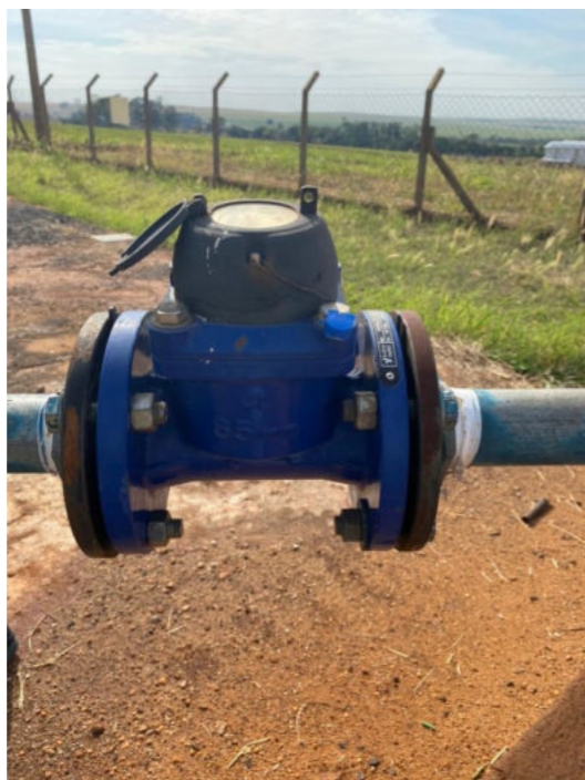
Figura 63 – Macromedidor poço UP 11.
