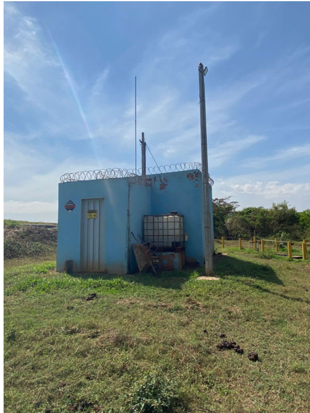
Figura 158 – Casa do Gerador.
