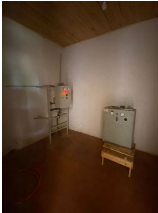
Figura 83 – Casa de máquinas.
