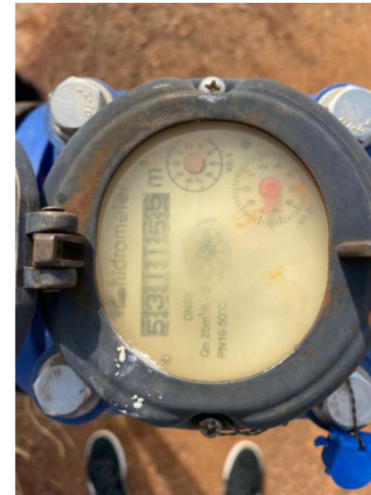
Figura 64 – Medição Macromedidor UP 11.
