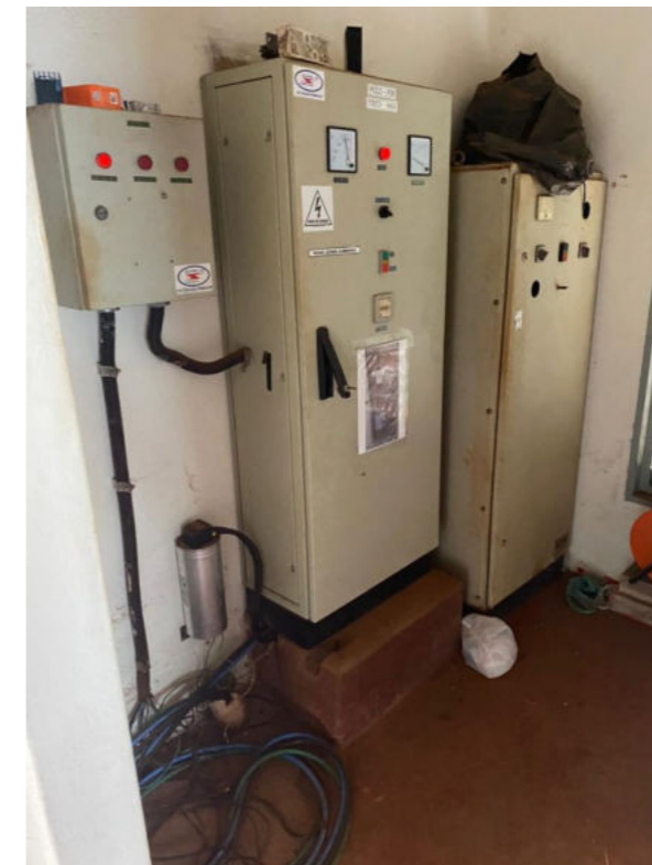
Figura 32 – Painéis de comando.
