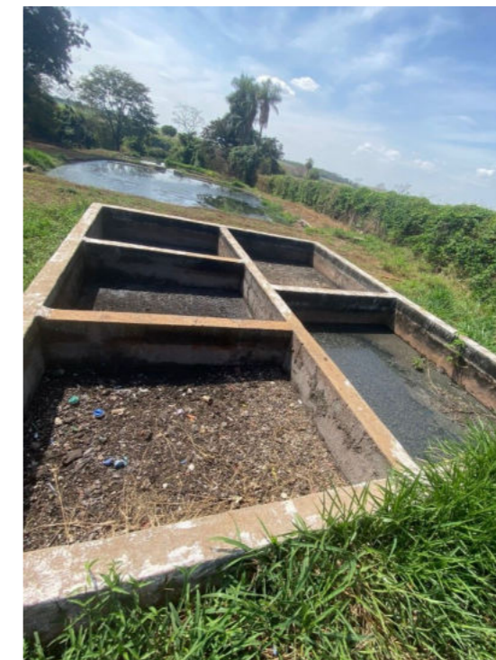
Figura 164 – Caixa de Recebimento de efluentes.
