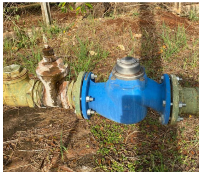
Figura 15 – Macromedidor Poço UP03.
