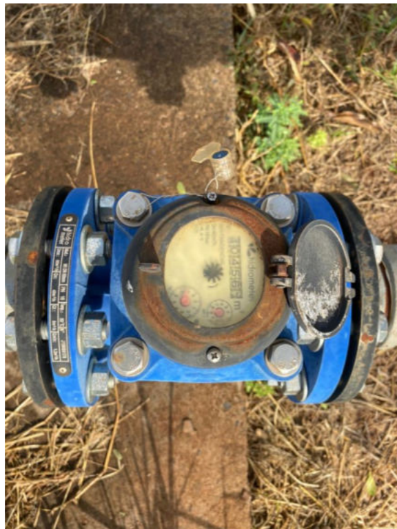
Figura 73 – Medição Macromedidor UP 12.
