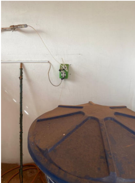
Figura 49 – Bomba dosadora de flúor.
