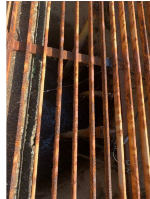
Figura 141 – Poço de Sucção da EEE Sete de Setembro.
