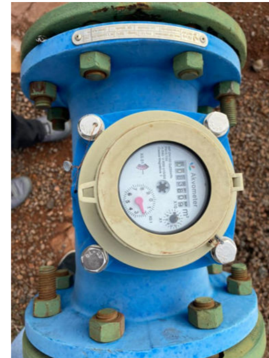
Figura 27 – Medição macromedidor UP06.
