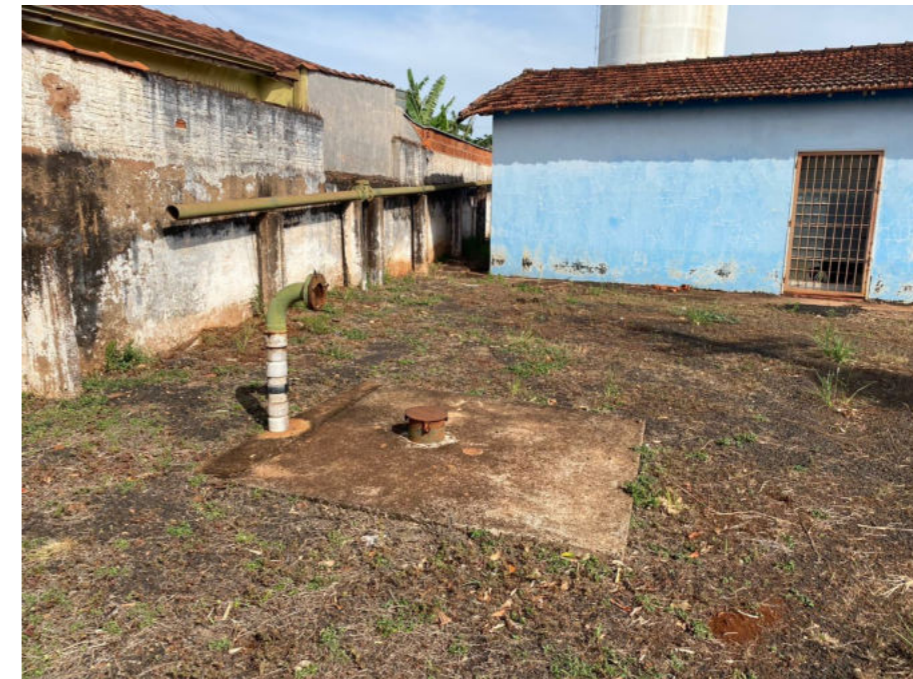
Figura 99 – Poço UP 02 desativado.
