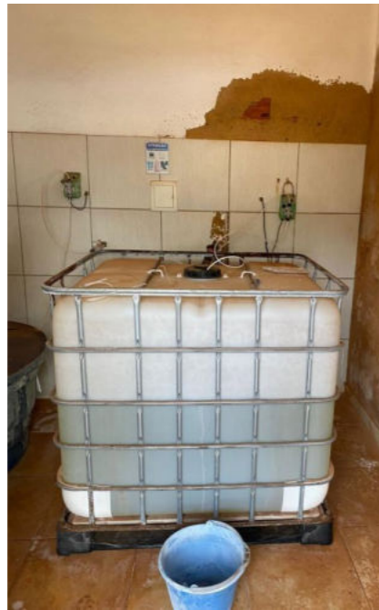
Figura 57 – Dosagem de cloro e flúor.
