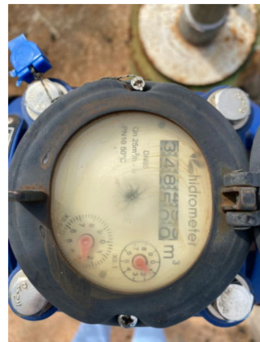
Figura 46 – Medição Macromedidor UP 09.
