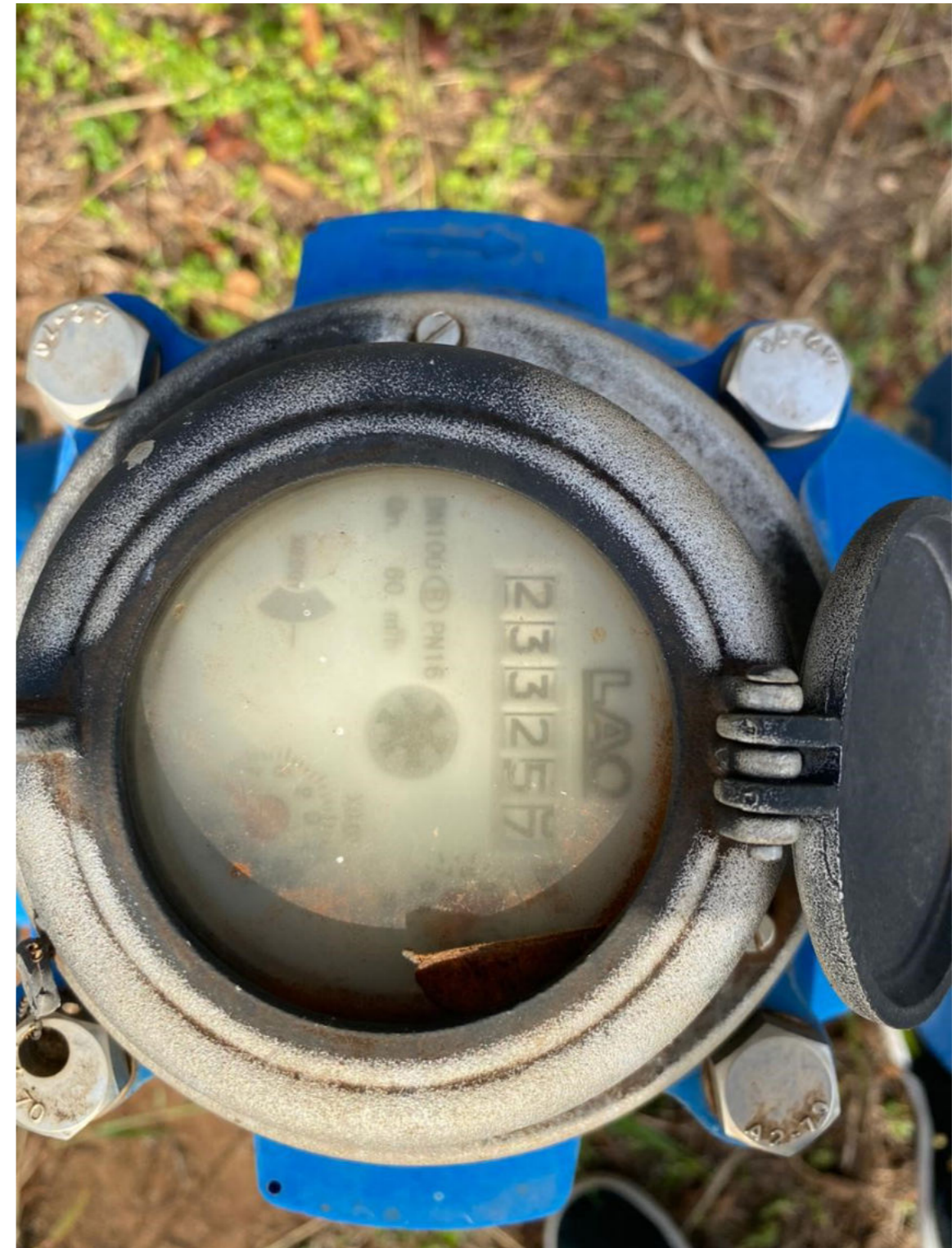
Figura 16 – Medição do Macromedidor Poço UP03.
