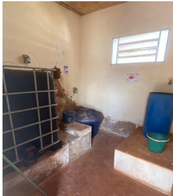
Figura 86 – Dosagem de cloro e flúor.
