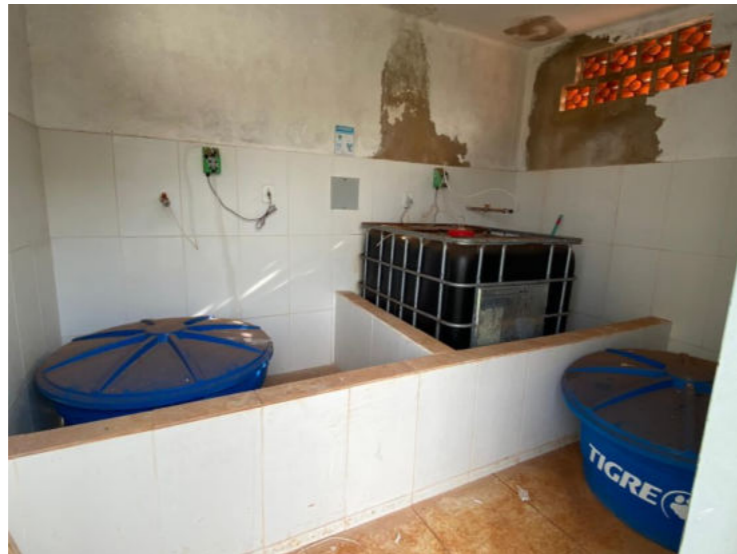
Figura 75 – Dosagem de cloro e flúor.
