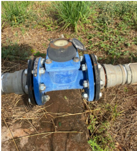
Figura 72 – Macromedidor poço UP 12.
