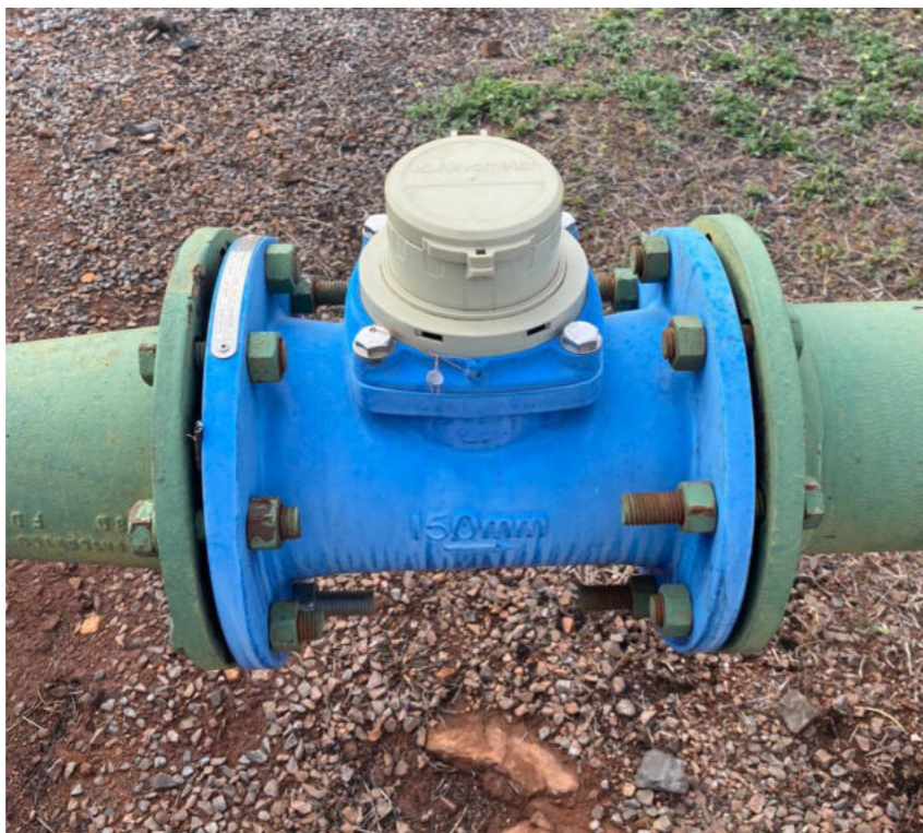
Figura 26 – Macromedidor Poço UP06.
