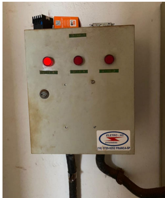
Figura 30 – Painel de comando.
