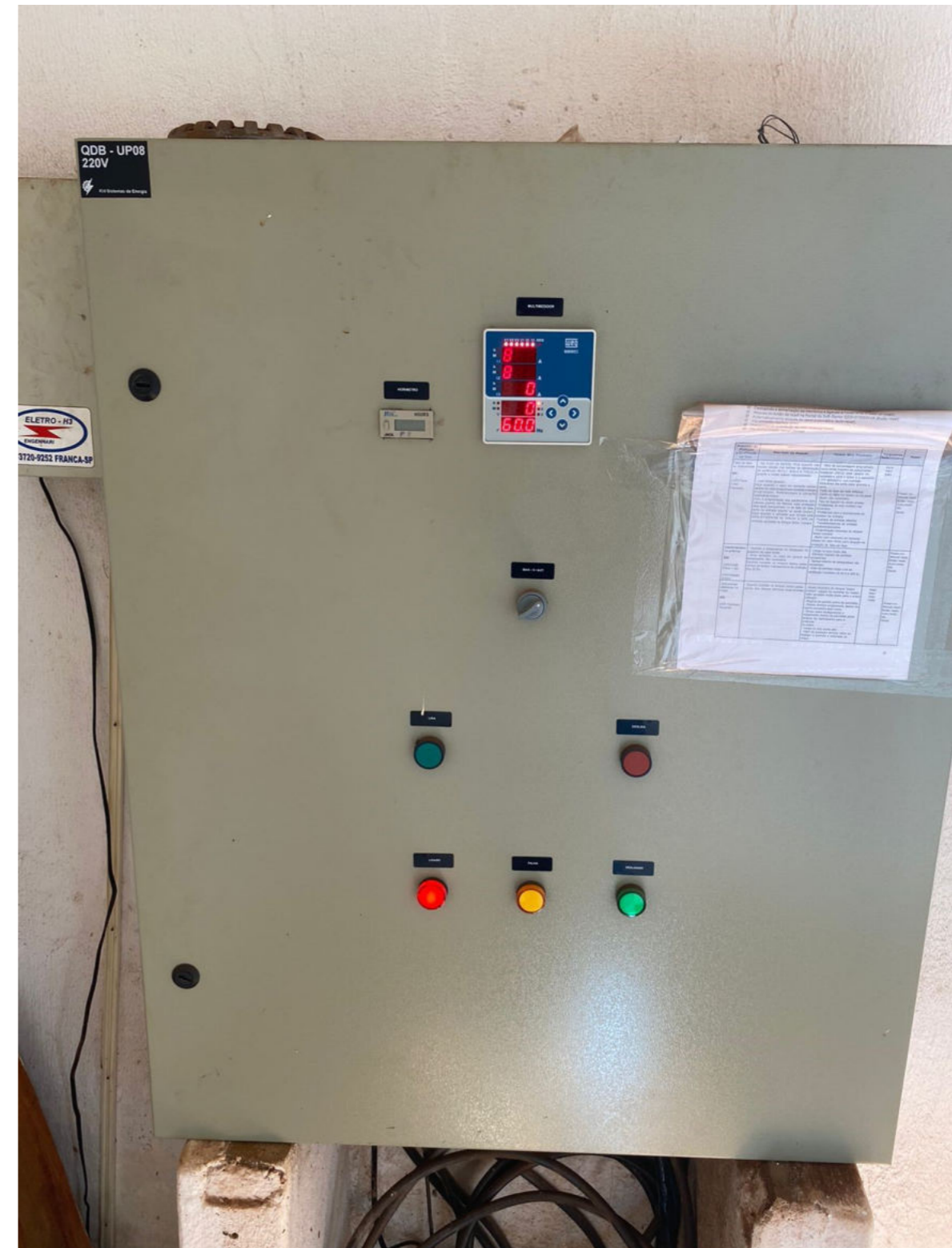
Figura 38 – Painel de Comando.
