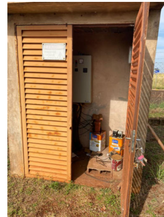
Figura 65 – Casa de máquinas.
